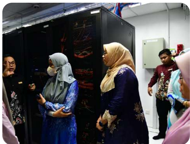
Lawatan ke Pusat Data di Tingkat 16, Menara PGRM.
